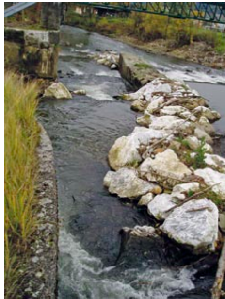
Fischpass an der Kainach
